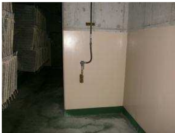
R/A 給気バックフィルタ室
