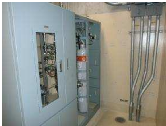
PASS ラックおよび可とう電線管
