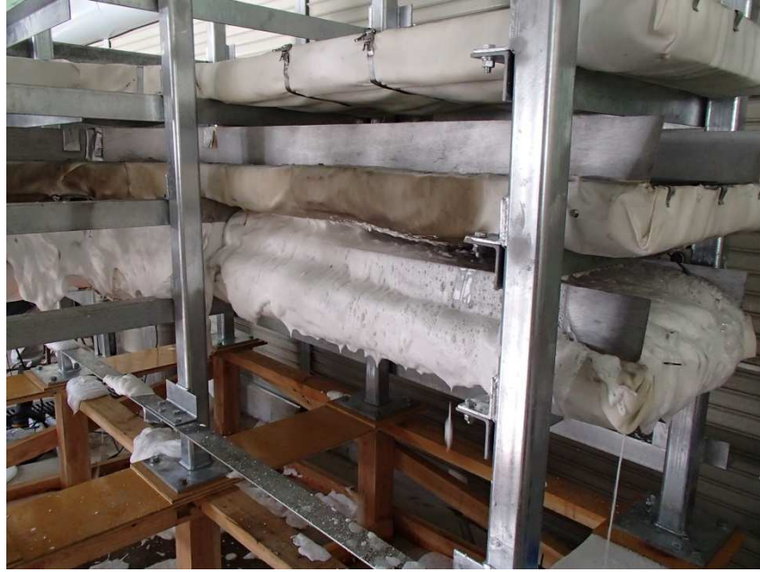
図 10 消火後の泡消火剤付着状況
