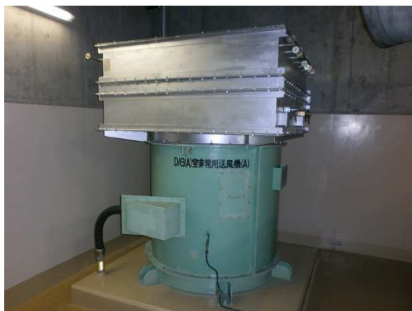
非常用送風機および可とう電線管
