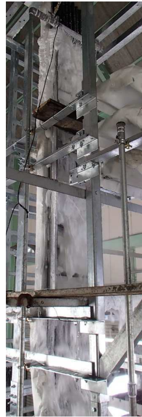
消火後の泡消火剤付着状況
