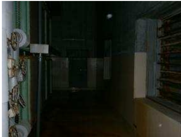
RW/A 給気冷却加熱コイル室
