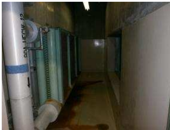
原子炉補機(A)室給気冷却コイル室
