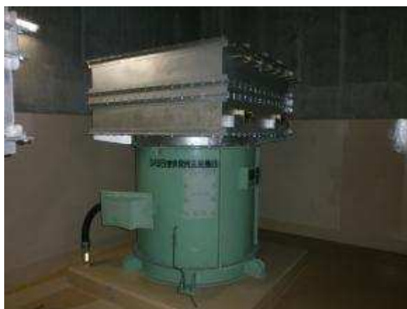
非常用送風機および可とう電線管
