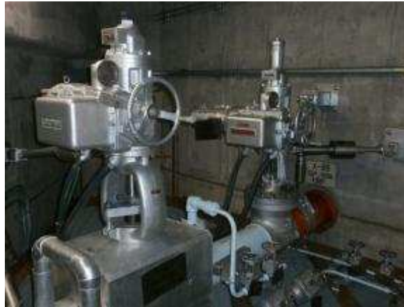
電動弁および可とう電線管
