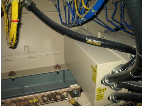
図9 フレキシブルコンジットの使用状況
