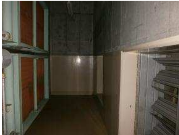
原子炉補機(HPCS)室給気加熱コイル室
