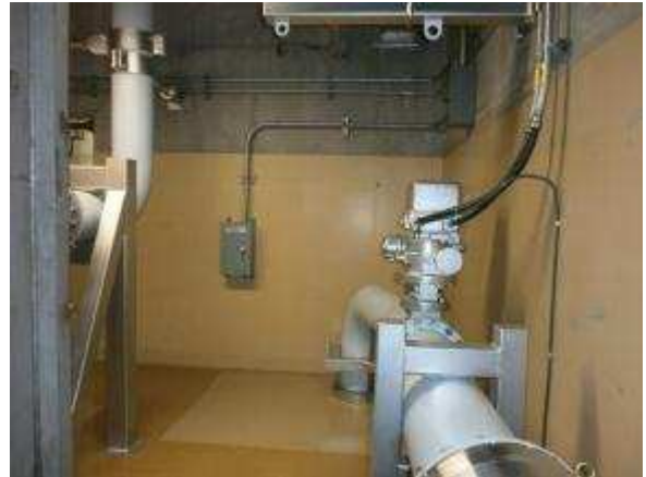
非常用ガス処理系フィルタ装置 活性炭充填排出装置電源 460V
