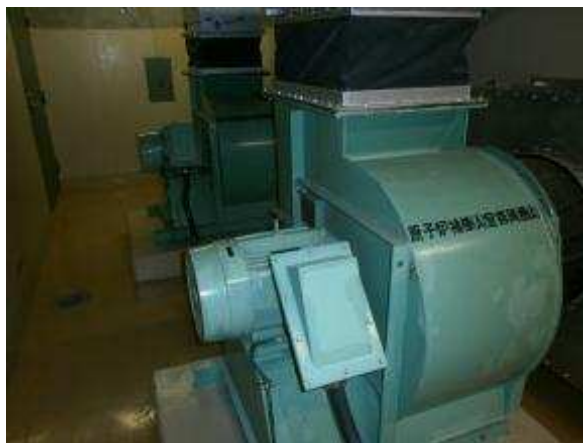
排風機本体および可とう電線管
