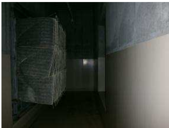
原子炉補機(HPCS)室給気バックフィルタ室
