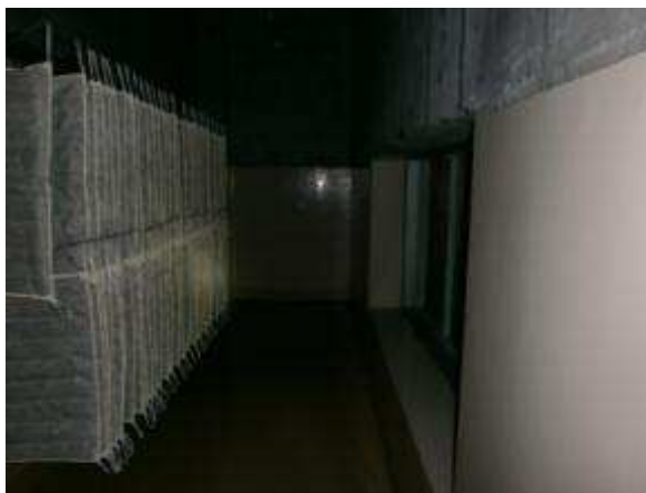
原子炉補機(B)室給気バックフィルタ室
