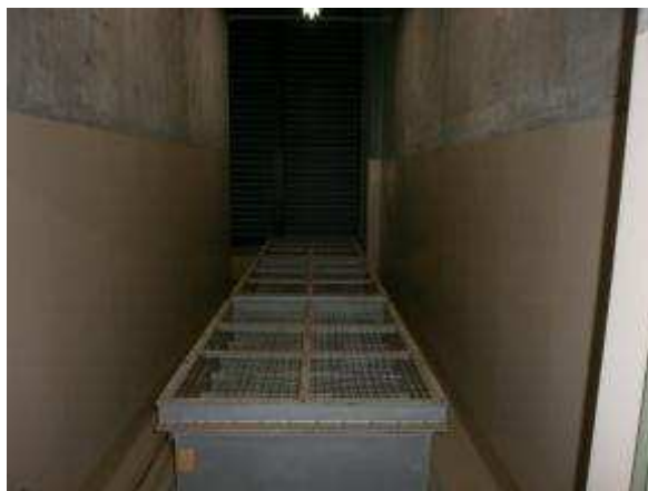
D/G(HPCS)室非常用排気チャンバ室
