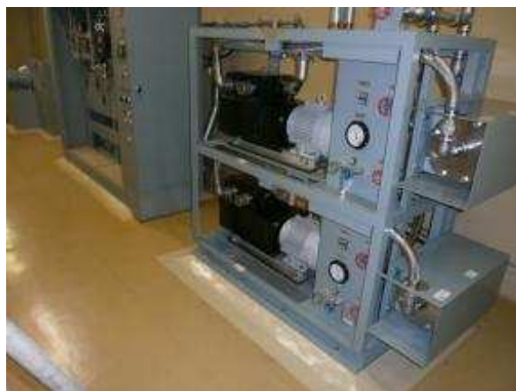
ダスト放射線ポンプ本体および可とう電線管
