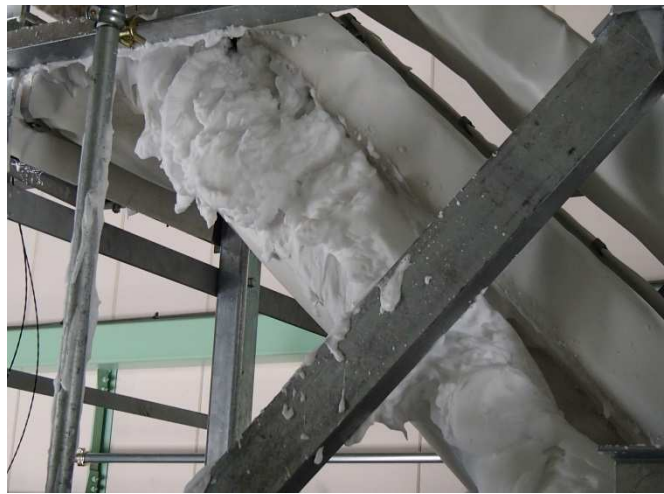
図 15 消火後の泡消火剤付着状況
