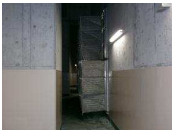
T/B 給気バックフィルタ室
