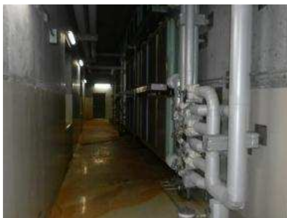
T/B 給気冷却加熱コイル室
