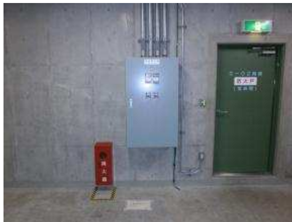
排煙動力盤 460V
