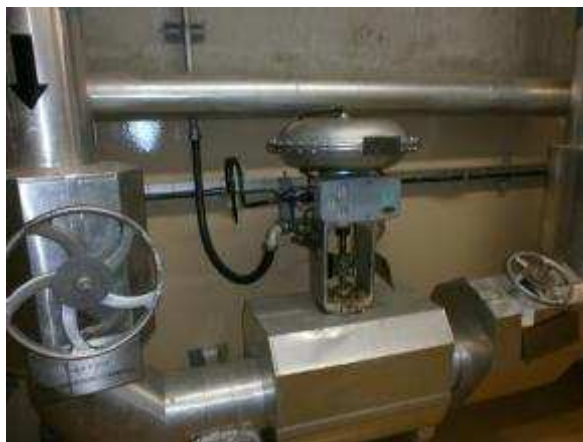
空気作動弁および可とう電線管
