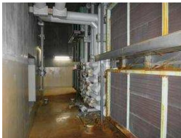
R/A 給気冷却加熱コイル室
