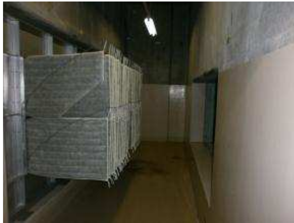
原子炉補機(A)室給気バックフィルタ室
