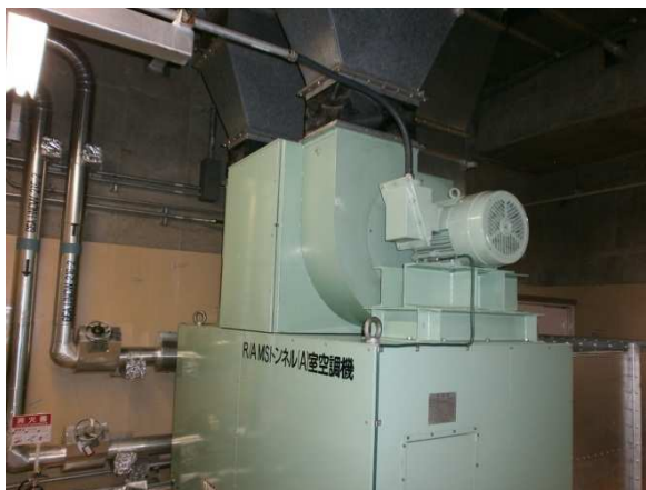
空調機本体および可とう電線管
