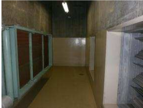
原子炉補機(A)室給気加熱コイル室
