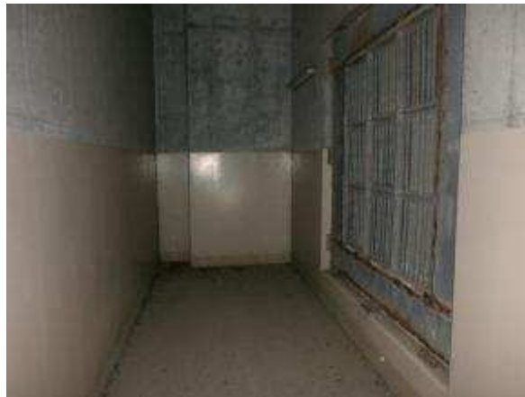
原子炉補機(HPCS)室給気チャンバ室
