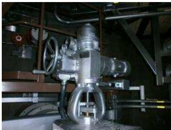
電動弁および可とう電線管
