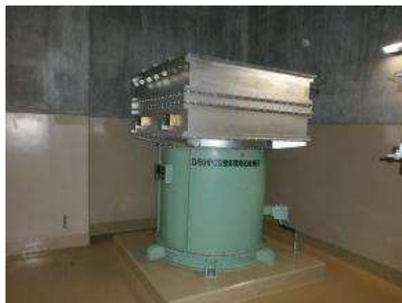
非常用送風機および可とう電線管
