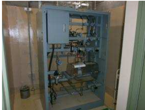
サンプリングラックおよび可とう電線管
