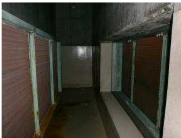
原子炉補機(B)室給気冷却コイル室
