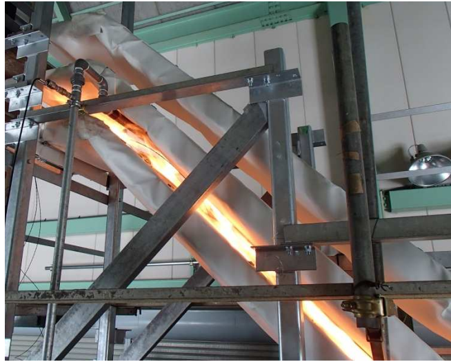
図 14 ケーブル火災状況
