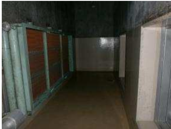
原子炉補機(B)室給気加熱コイル室
