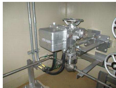
高圧窒素ガス供給元弁
