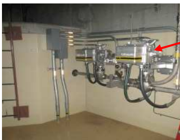
HPIN 常用非常用窒素ガス連絡弁(A)
