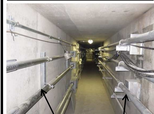
電線管 燃料移送配管 ※露出ケーブルは仮設
