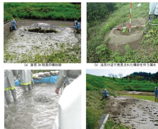
(a) 直径 3m 程度の噴砂跡 (b) 法尻付近で発見された噴砂を伴う漏水 (c) 噴砂を伴う漏水の状況 (d) 堤脚水踏踏で生じた噴砂 写真 - 3 噴砂を伴う漏水の事例
