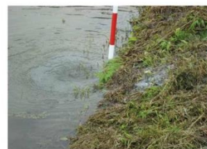
写真 - 2 法尻からの漏水の事例
