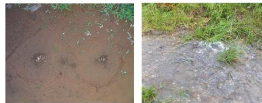
(a) 砂質土の場合 (b) 礫質土の場合 写真 - 1 法尻もしくは法尻近傍の堤内地からの漏水の事例
