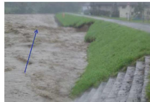
写真-7 表法面の侵食が発生した事例
