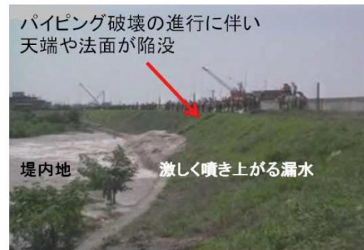
写真-9 激しく噴き上がる漏水によって天端や法面が陥没した事例
