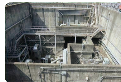
海水ポンプなどが設置されている立坑(ピット)
