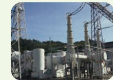
開閉所のガス遮断機
