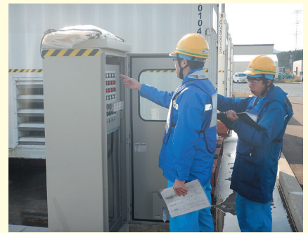
大容量電源装置の起動訓練
