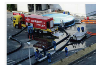
大容量送水ポンプ車による冷却機能確保訓練
