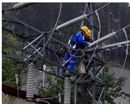
送電線との接続
