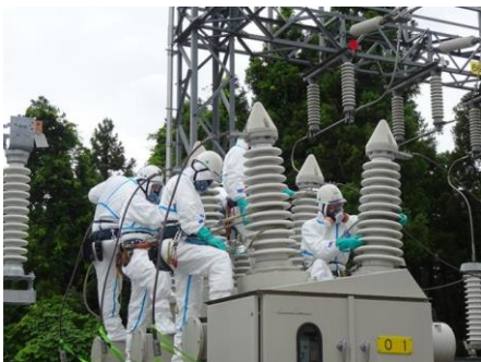
66kV遮断器点検
