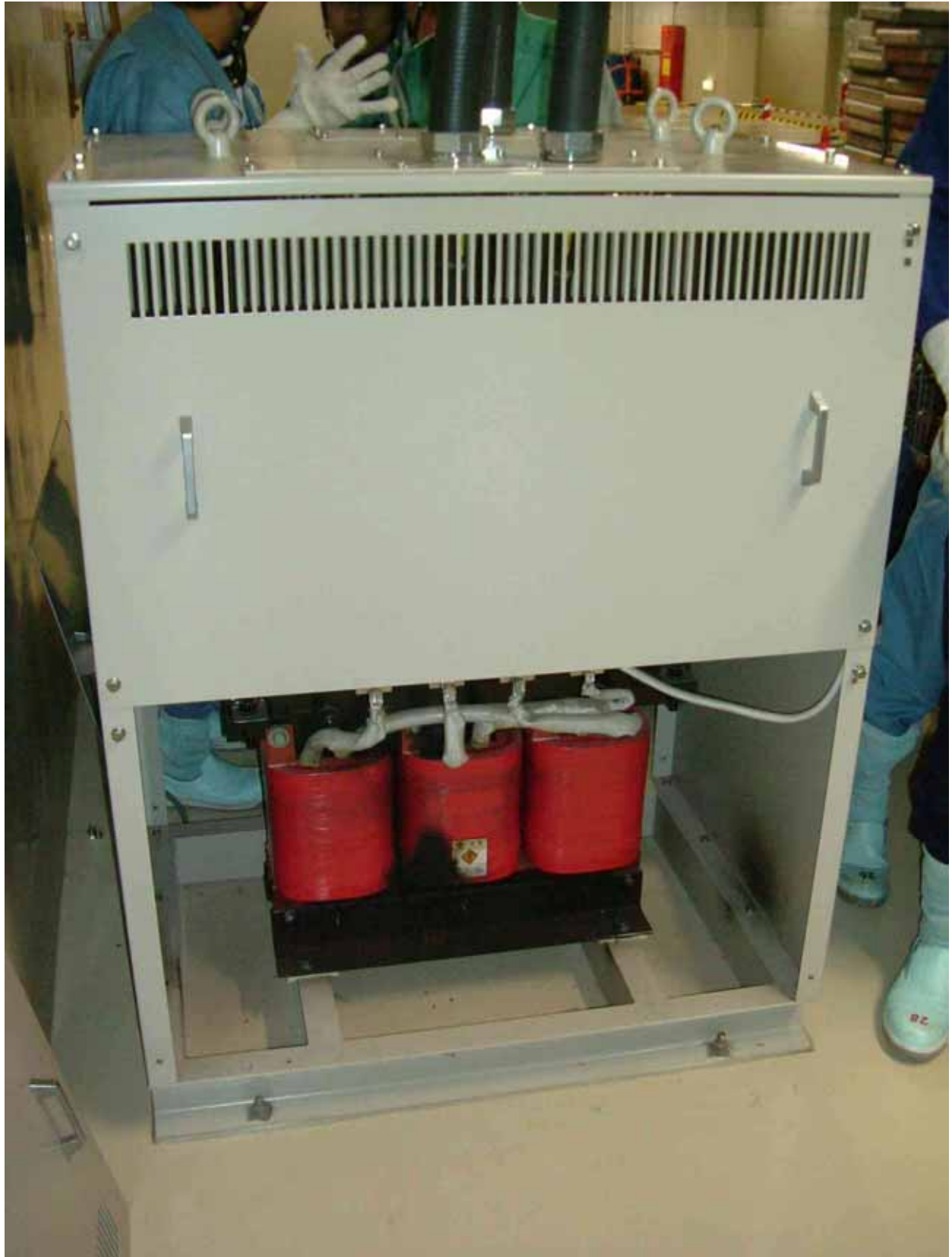
現場写真 - 2 ( 火災跡 )
