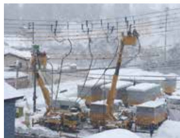
応急高圧電源車による送電の様子
