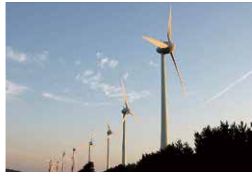
能代風力発電所（1万4,400kW）（秋田県能代市） （東北自然エネルギー（株））
