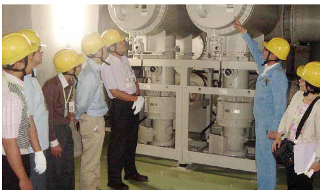
研修生に変電設備を説明する様子
