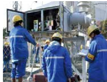
技能大会 変電部門 (66kV真空遮断器 臨時点検ほか)
