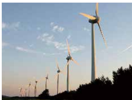
能代風力発電所 (14,400kW) (秋田県能代市) (東北自然エネルギー開発(株))
