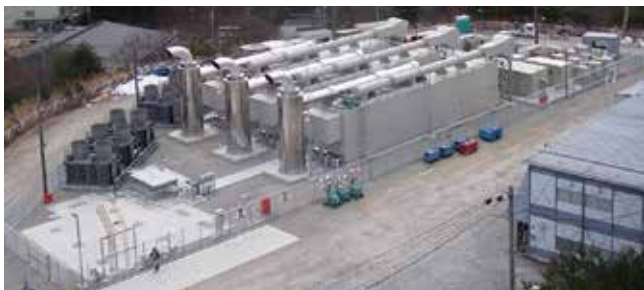
女川原子力発電所に設置した大容量電源装置3台（出力1台：5,000kVA）
