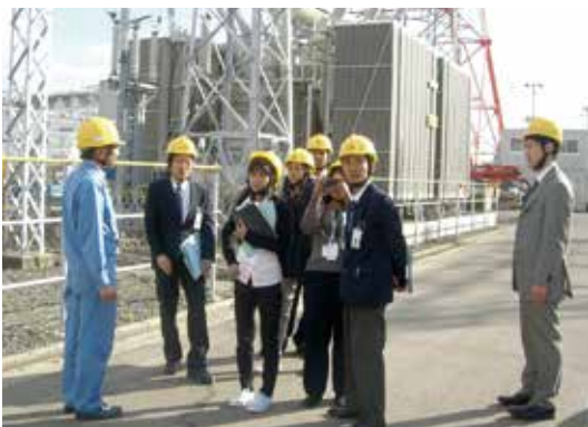
変電設備の説明を受ける海外からの研修生
