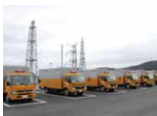
女川原子力発電所に配備した電源車
