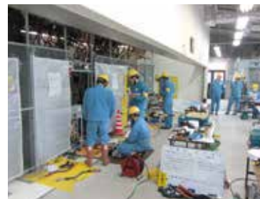
技能大会 変電部門 (6kV 真空遮断器受入試験他)
