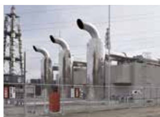
女川原子力発電所に設置した大容量電源装置
