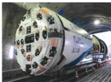
導水路掘削に使われている最新鋭のトンネルボーリングマシン（愛称「玉二郎」）
