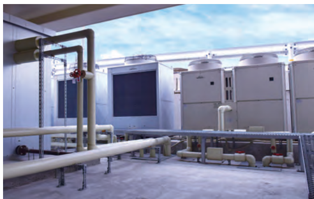
福祉施設に導入されたヒートポンプ給湯システム
