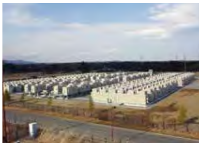
南相馬変電所蓄電池システム（福島県南相馬市）
