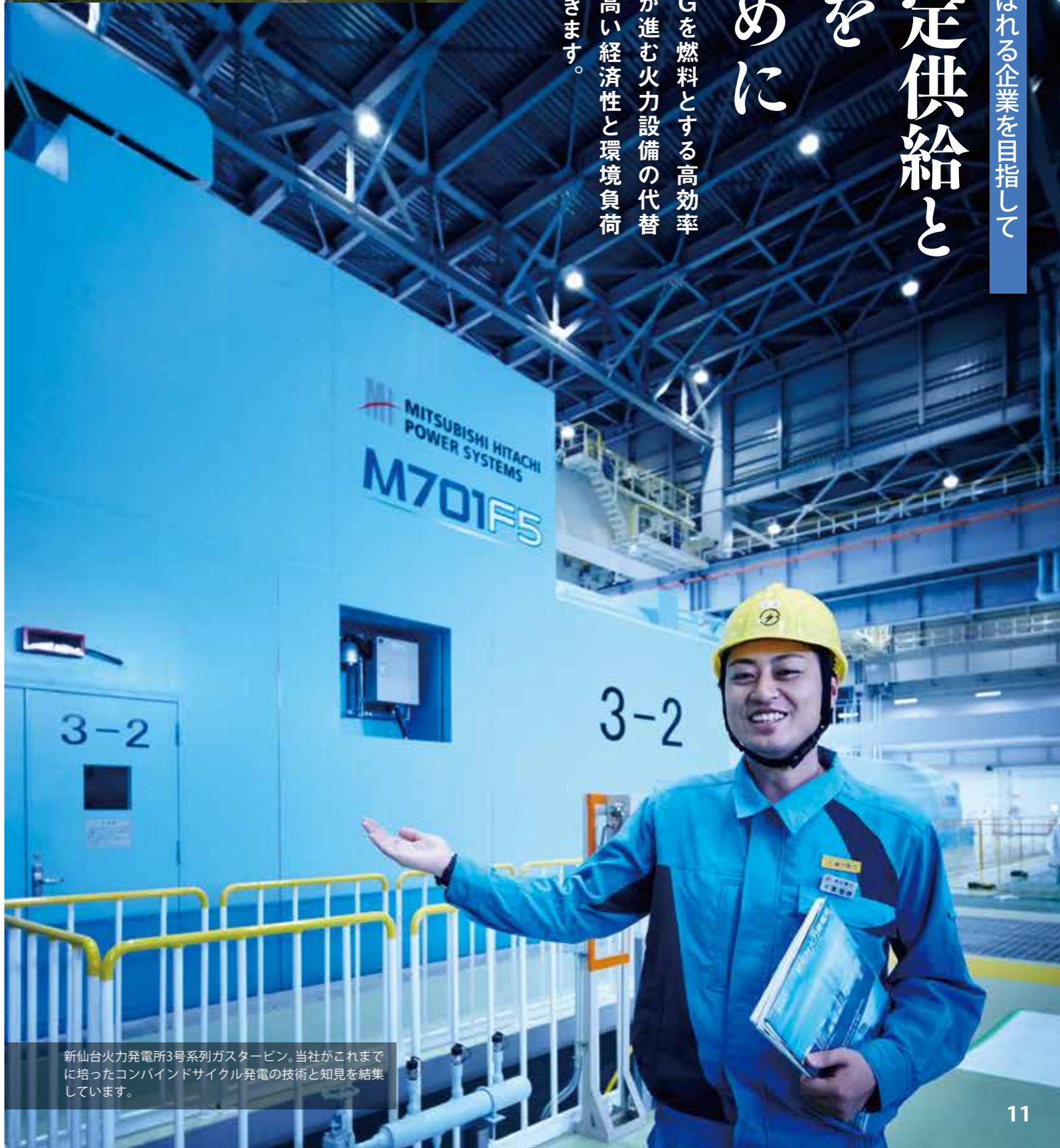
新仙台火力発電所排熱回収ボイラー。ガスタービンから出る排ガスの熱を有効利用して熱交換を行い、水を蒸気に変えて発電に利用しています。
