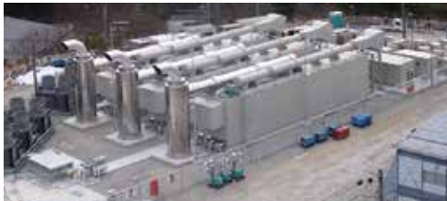
女川原子力発電所に設置した大容量電源装置3台 (出力1台：5,000kVA)
