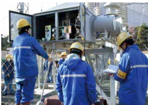
技能大会 変電部門（66kV 真空遮断器 臨時点検ほか）
