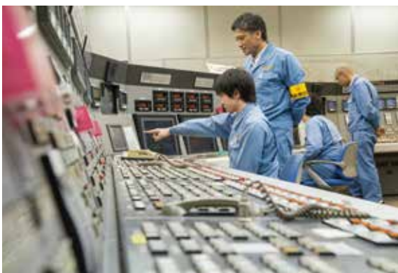
上/東新潟火力発電所3号系列のガスタービン外観。 下/運転開始以来約30年間、東新潟火力発電所3号系列を見守ってきた中央制御室。
