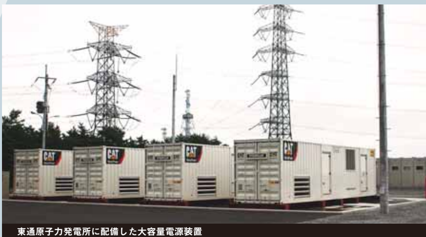
東通原子力発電所に配備した大容量電源装置
