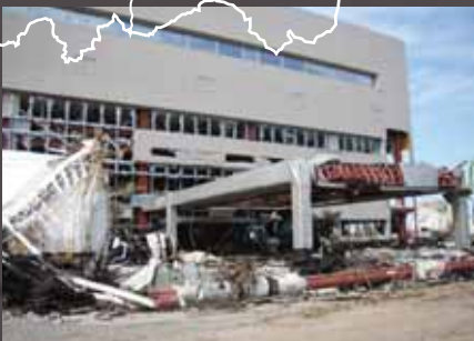
津波により破壊された事務本館(原町火力発電所)
