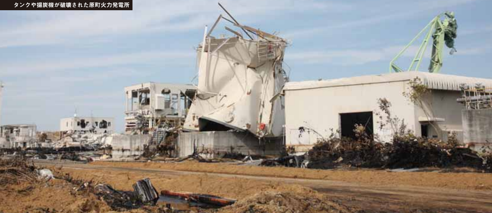
タンクや揚炭機が破壊された原町火力発電所
