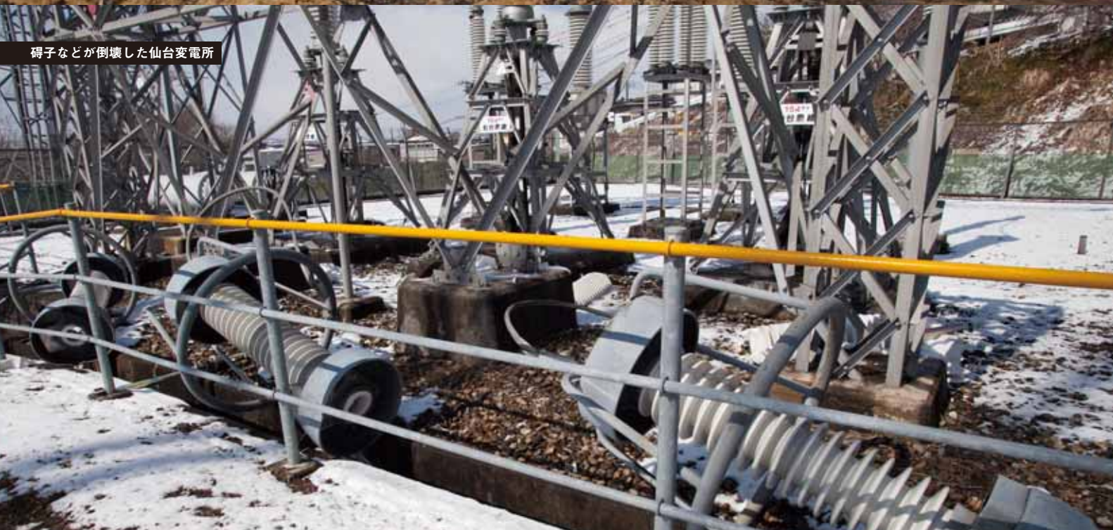
流れてきた貨車で折れた電柱(宮城県多賀城市)
