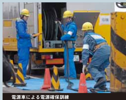
電源車による電源確保訓練
