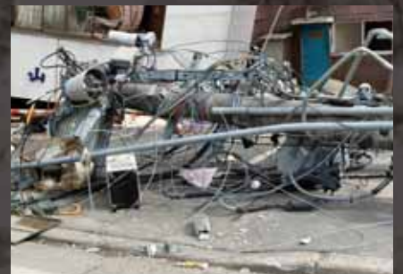
倒壊して原形をとどめない配電設備(宮城県気仙沼市)
