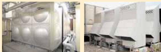
貯湯槽 室外機
