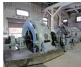
発電機・调速機装置・水車
