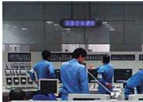
営業運転に入った東通1号機の中央制御室内
