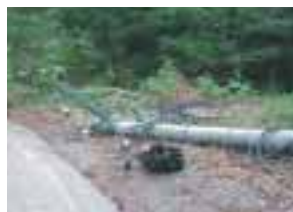
倒壊した電柱
