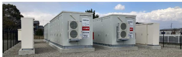
弥藤吾蓄電所
