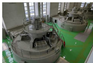
生保内発電所(水力)
