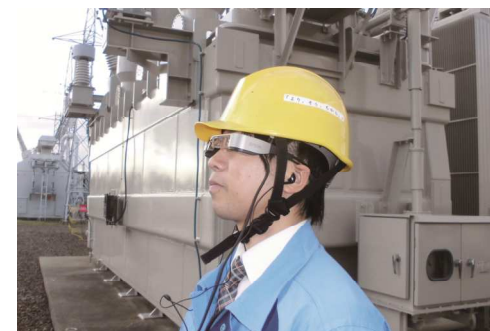
変電所の運転・保守業務の品質向上や効率化に向けた「スマートグラスシステム」の運用
