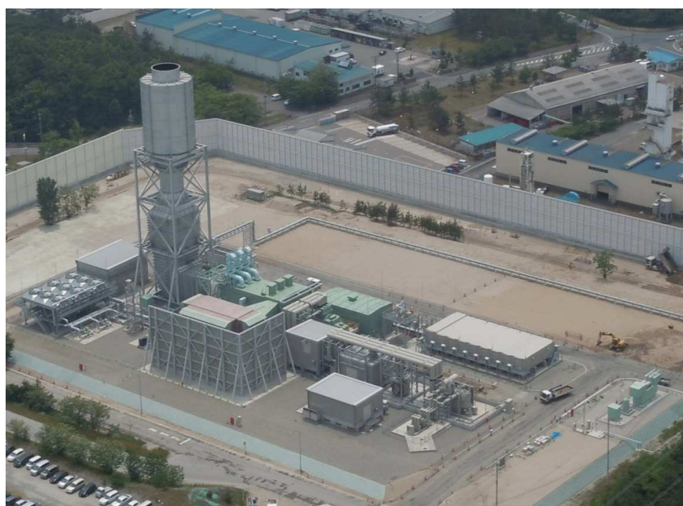
5 号機発電設備の全景
