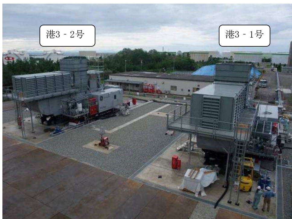
港 3 号系列発電設備の全景
