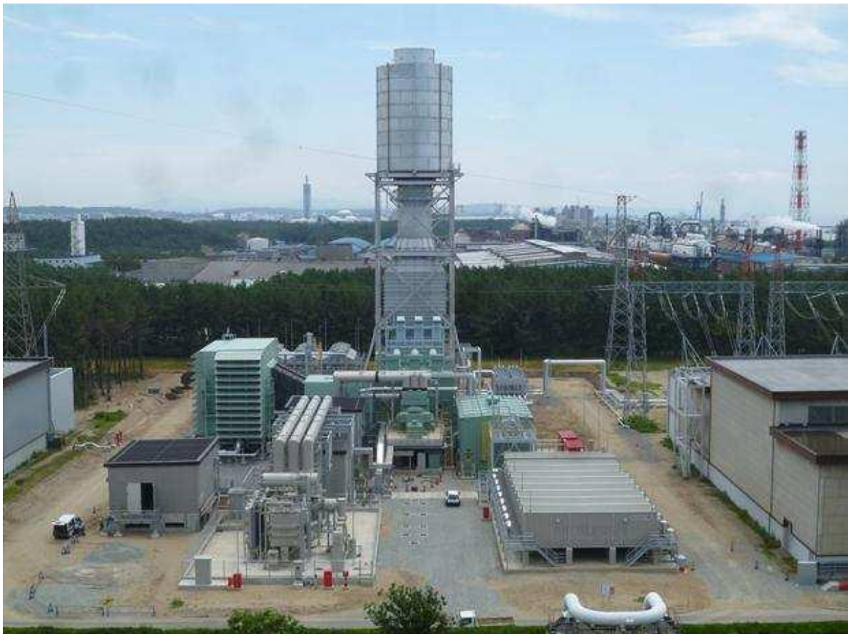
5 号機発電設備全景
