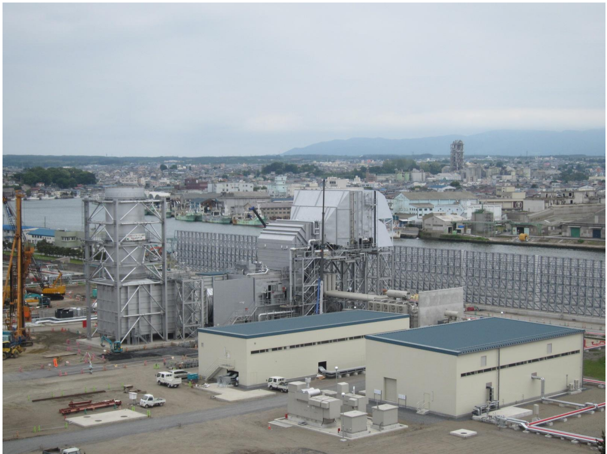
5 号機発電設備全景
