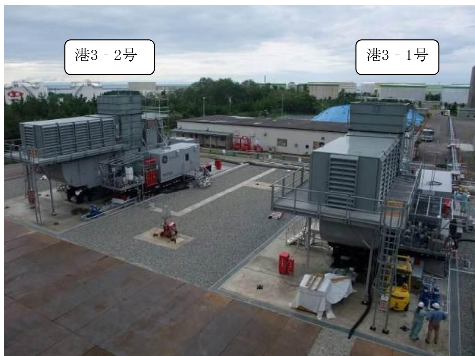
港 3 号系列発電設備の全景
