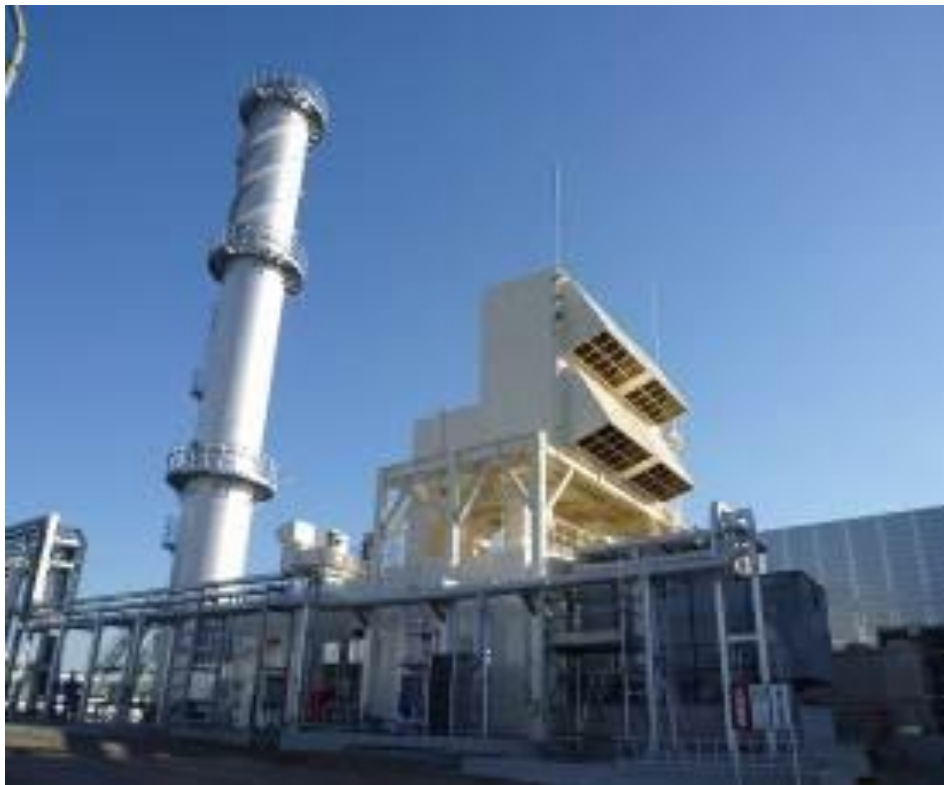
6 号機発電設備の全景
